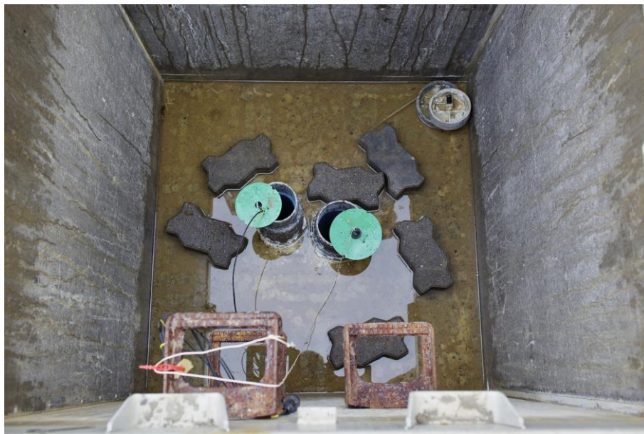
Abb. 4.90: Schachtbauwerk der GWM PN1 mit den Peilrohren des Flach- (links) und Tiefpegels (rechts). Eingedrungenes Oberflächenwasser bedeckt die Schachtsohle (Aufnahmedatum 12.10.2011).
